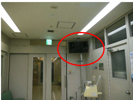
((⑦、32 型、天吊り))
