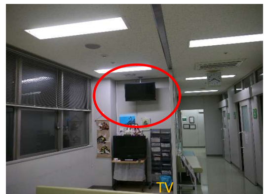
((⑧、32 型、天吊り))
